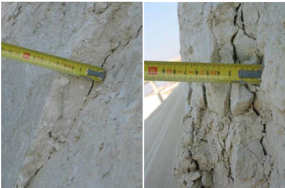
Vues de désordres de surface
